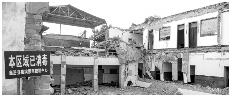
山西襄汾“8·29”重大坍塌事故现场 新华社记者 杨晨光 摄
