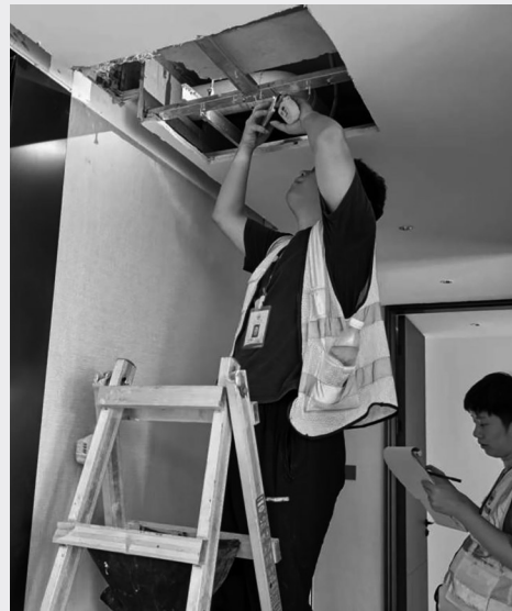
检测人员在查看被破坏的横梁 图据澎湃新闻
