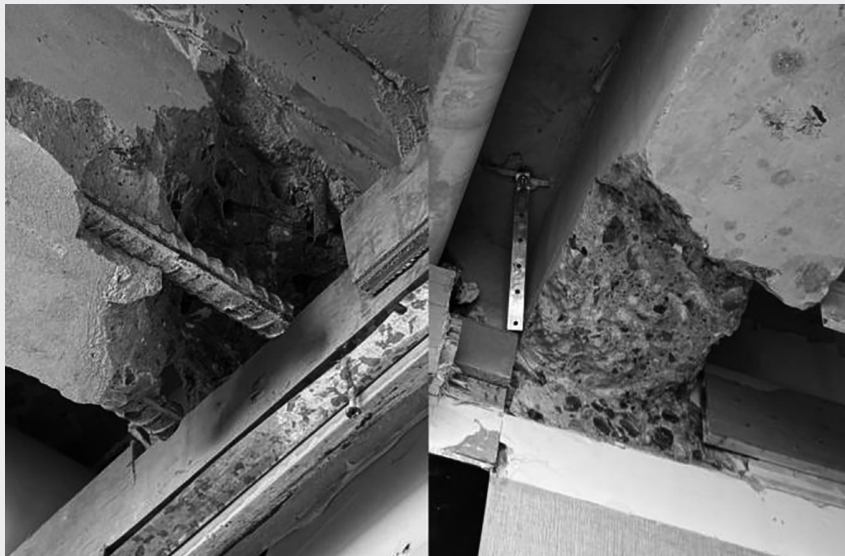
部分房屋次梁受损情况 新华社记者 谢奔 摄
