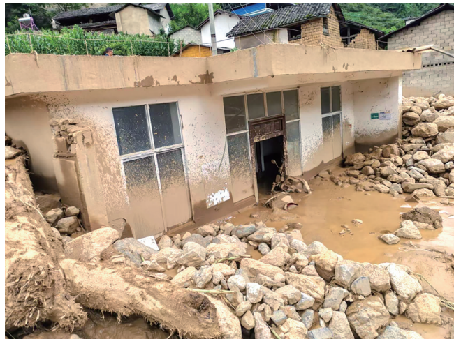
小河洼农户房屋受损现状
