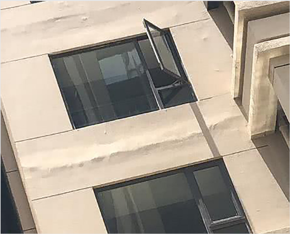
外墙起泡凹凸不平 本版图片均由樾府小区业主供图
