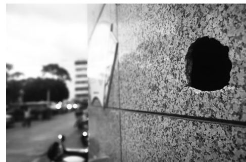
外墙上的显眼大洞长期没有修复
