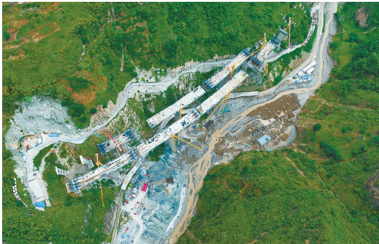
8月30日拍摄的位于金阳县境内芦稿林河下游的蜀道集团沿江高速JN1(金宁一)标段项目部钢筋加工场民工驻地板房(右上)已被山洪冲毁。 新华社记者 沈伯韩 摄
