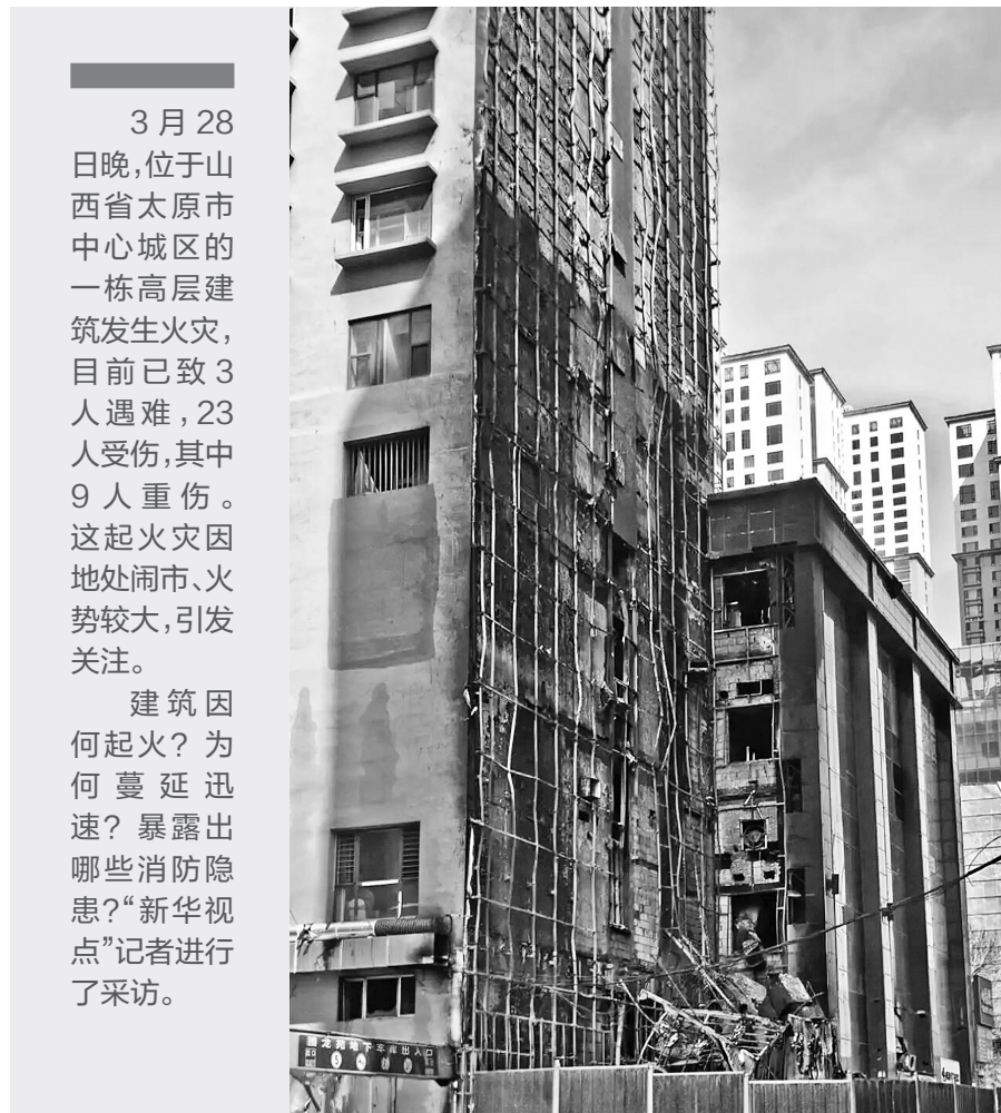
火灾后的大楼外立面 图据潇湘晨报
