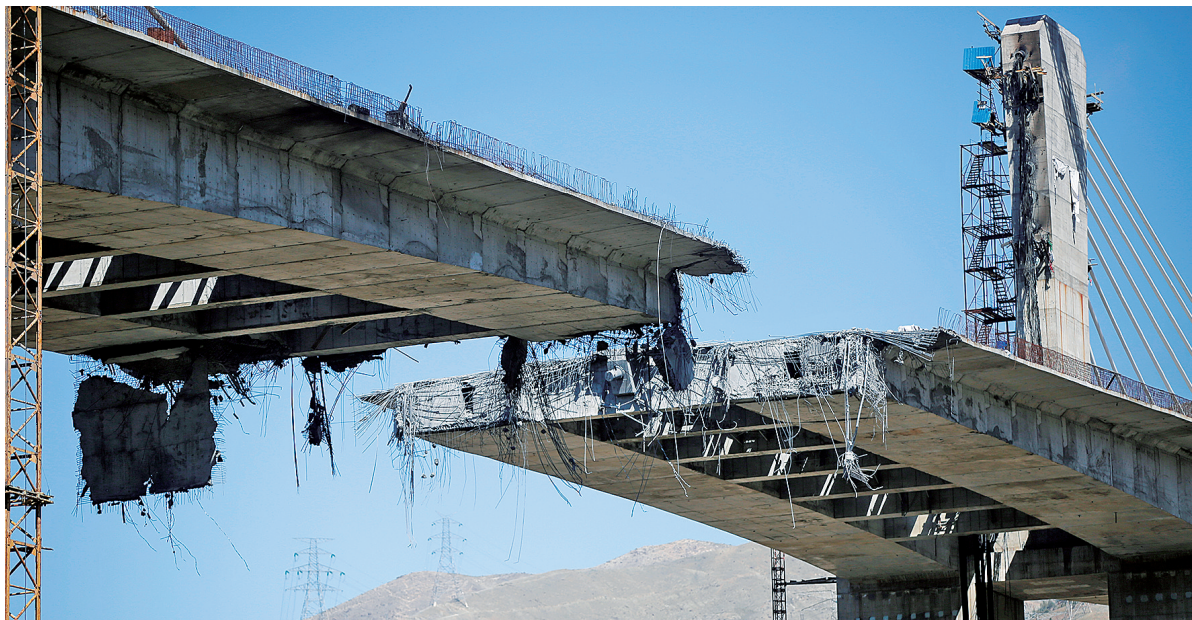
4月2日,伊朗卡拉季市贝伊克公路桥遭美国和以色列两次空袭,图为受损状况。新华社发
