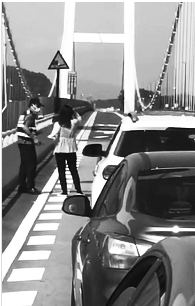
桥面出现较大幅度振动,司机停车观望。
